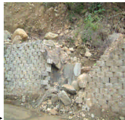
圖 13. GIS 點資料超連結勘災照片- 加勁擋土牆
